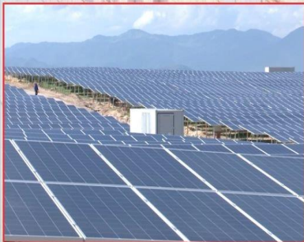
Nhà máy điện mặt trời Sinenergy Ninh Thuận Sinenergy Ninh Thuan solar power plant
