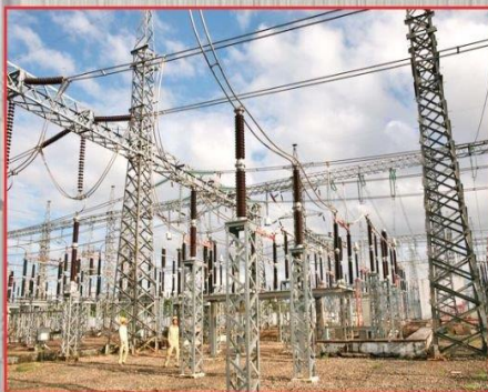
Trạm Biến Áp 500Kv Pleiku - Gia Lai Pleiku - Gia Lai Substation 500kv
