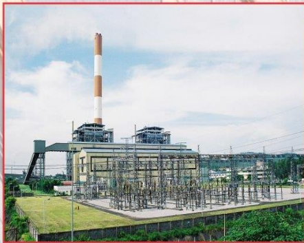
Trạm Biến Áp 500kv Nhiệt Điện Vĩnh Tân - Bình Thuận Substation 500kv of Vinh Tan - Binh Thuan thermal power
