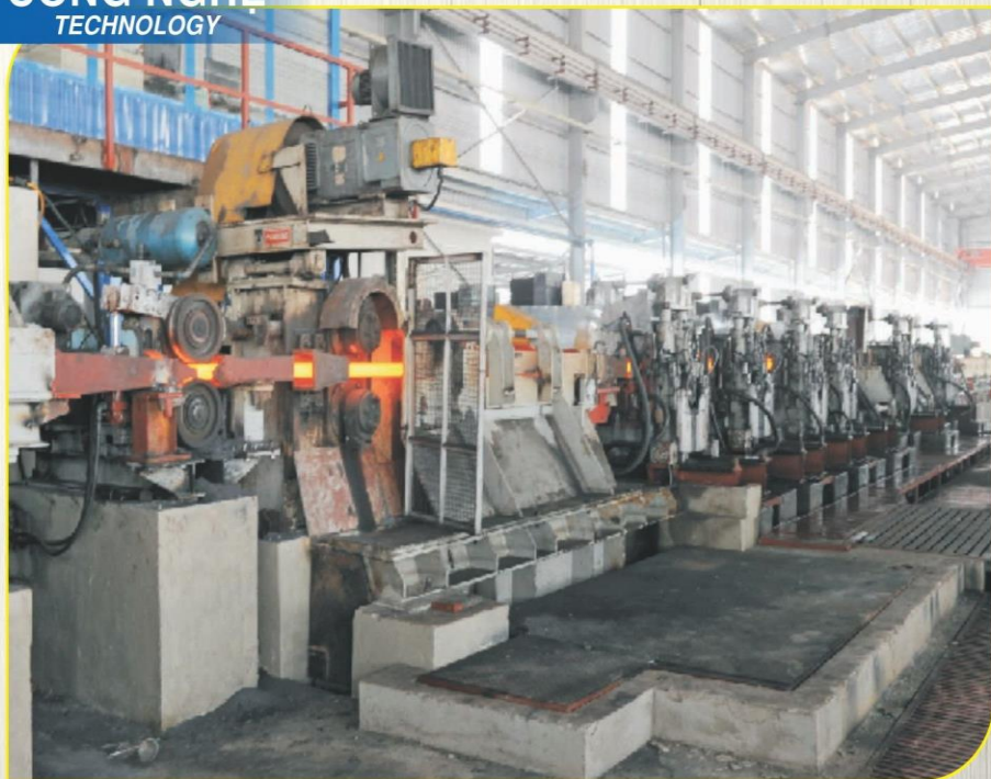
Dàn cán POMINI - Công nghệ của Italy đang vận hành ... Hi - tech rolling mill from Pomini Italy is running ...
