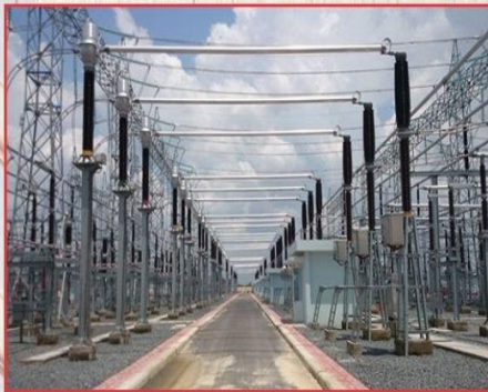
Trạm Biến Áp 500kv Cầu Bông - Củ Chi Cau Bong - Cu Chi Substation 500kv
